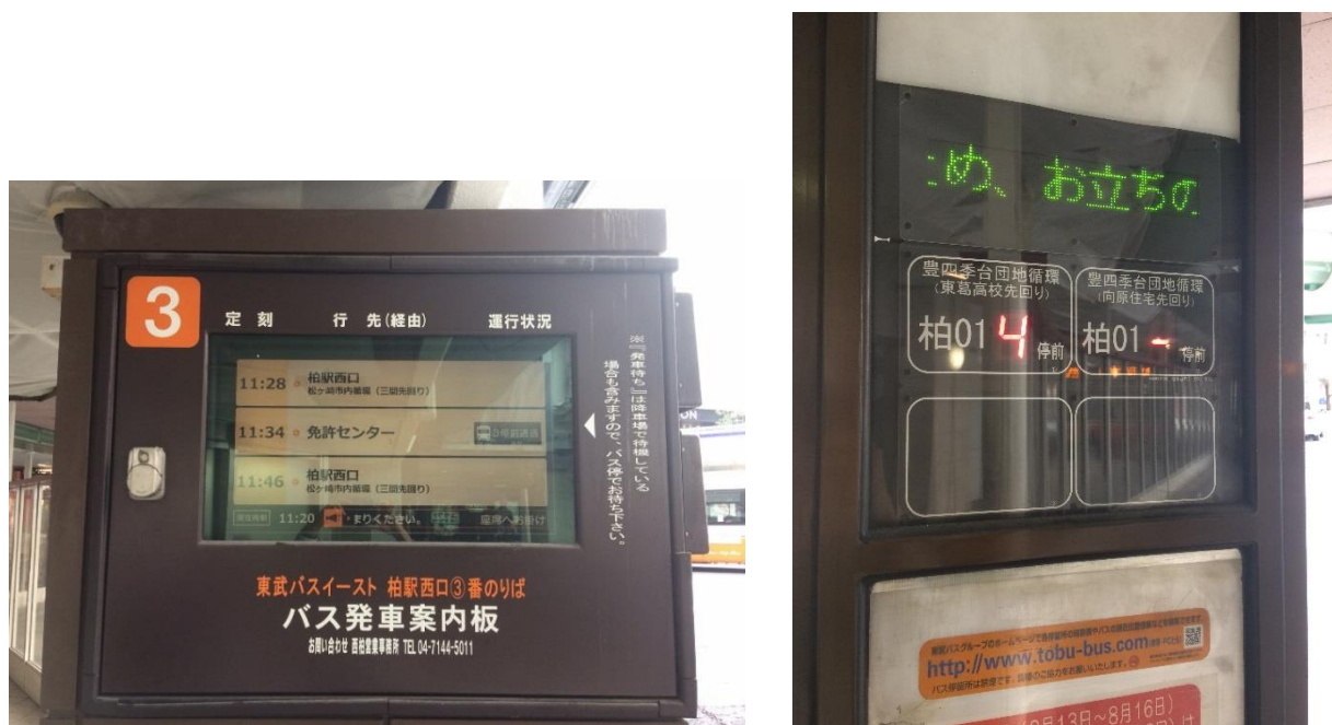
図 2-32 柏駅西口におけるバス停でのバスロケーションシステムによる到着時刻案内
