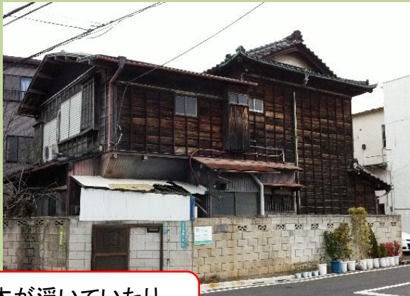
下地露出はないが、木が浮いていたり、 腐食、著しい塗装のはがれなど
