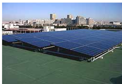
図.千葉市中央卸売市場の太陽光発電
