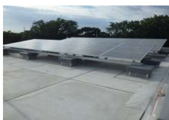
屋上に設置した太陽光発電設備
