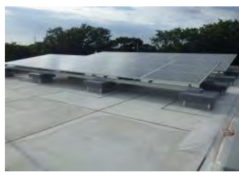
屋上に設置した太陽光発電設備
