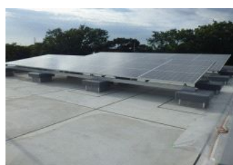
屋上に設置した太陽光発電設備
