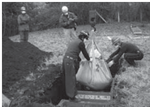
除染工事(コンクリート容器を埋設し、その中に汚染土壌を収容、上部に30センチメートルの覆土)
