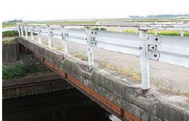
■老朽化した橋梁
