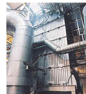
かつせいたんきゅうちやくどう ■活性炭吸着塔 排ガス中のダイオキシンを除去します。
