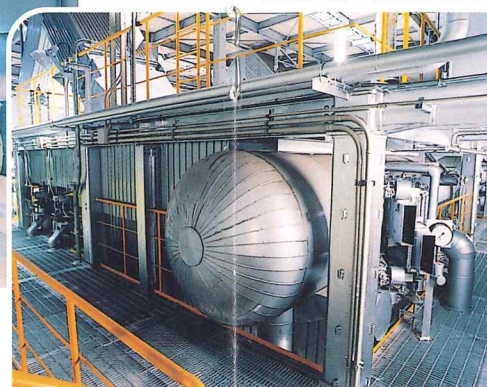
がいかん ■ボイラ (外観) 焼却炉で発生する排ガスの温度を下げる的同时に、回収した熱で蒸気を発生させます。
