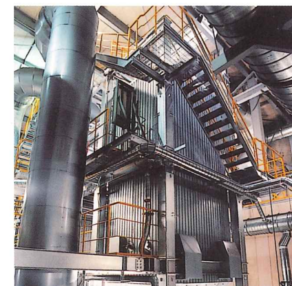
しよくばいはんのうどう ■触媒反応塔 排ガス中の窒素酸化物を除去します。
