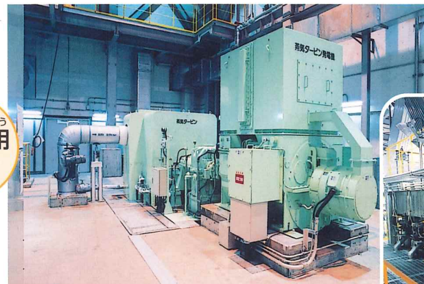
じょうき はつでん き ■蒸気タービン発電機 ボイラで発生した蒸気を利用してタービンを回し、最大2,500kWの発電を行います。
