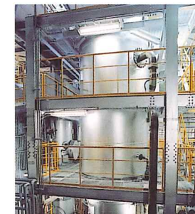
しっしきせんえんどう ■湿式洗煙塔 排ガス中の有害物質を除去するため、水で洗浄します。
