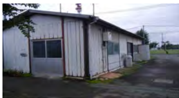
建物の老朽化（陶芸室）
