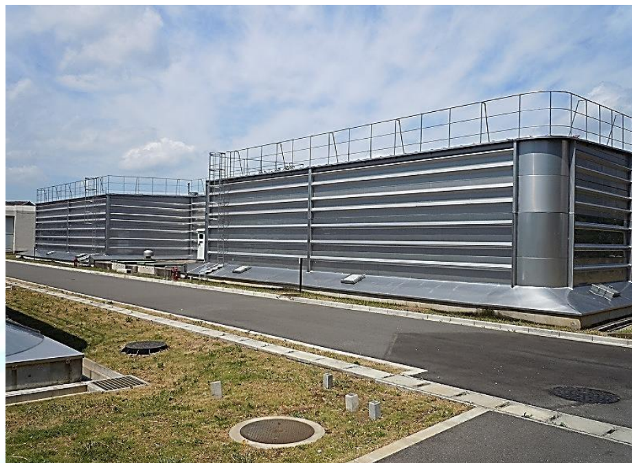
＜第三水源地＞ ステンレス配水池 3300m 3
