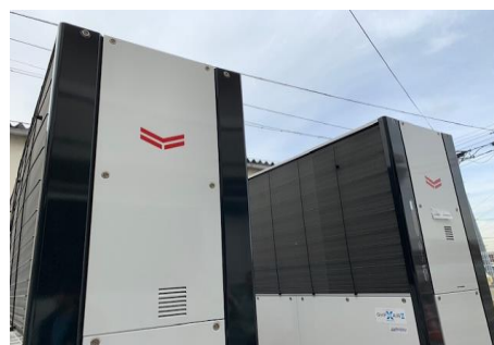
図 沼南庁舎のコージェネレーションシステム
