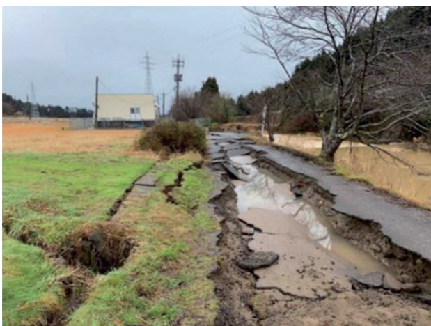
水源から浄水場に送る導水管の被災
