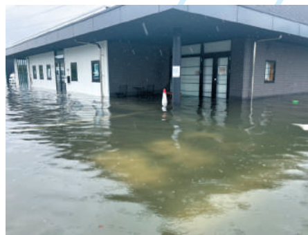
令和5年6月の被害。施設内の機材や備品が浸水で使用不可能に
