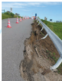
令和5年6月の被害。道路のり面が崩れた
