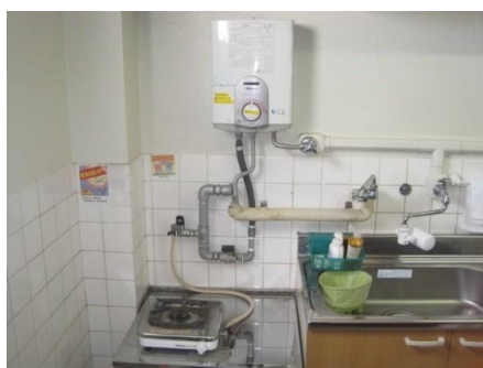
ガス臭の確認
