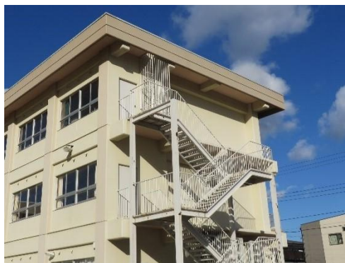
屋外階段の腐食, ぐらつきの確認
