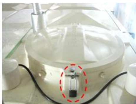
受水槽点検口の施錠確認
