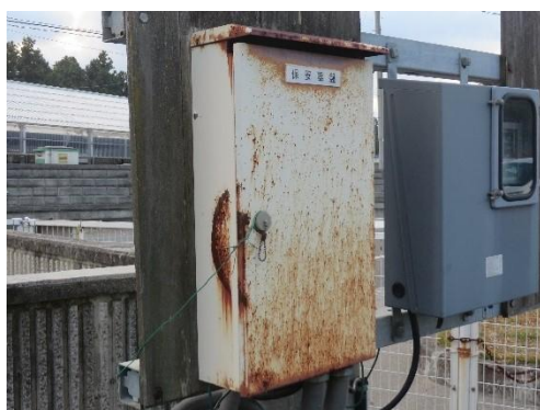
錆の状態確認
