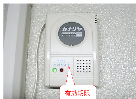
ガス漏れ警報器の有効期限の確認
