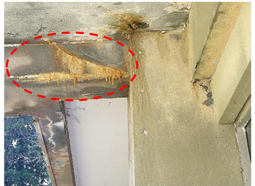
コンクリートの錆汁, 白華
