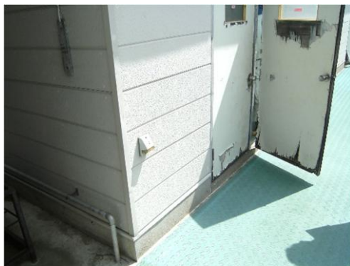
扉の錆や腐食
