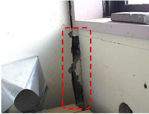
壁のひび割れ，破損
