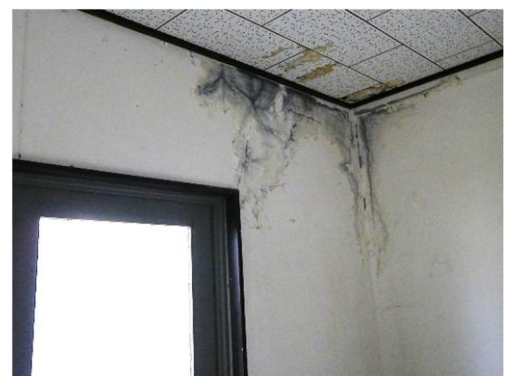
雨漏りによる壁面のシミ
