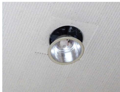
ダウンライトの落下の危険
