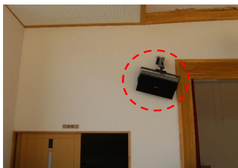
壁面スピーカの脱落
