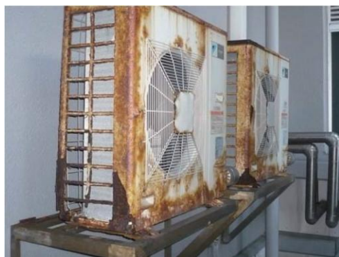
室外機の腐食
