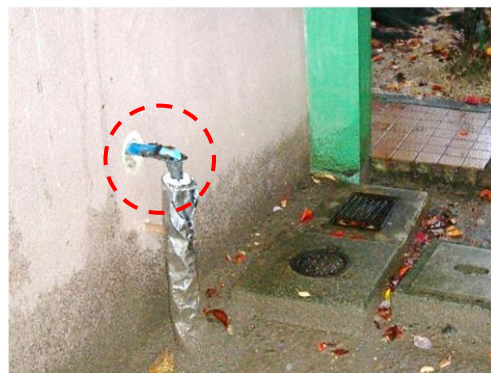
管保温材の破損（水道凍結の恐れ）
