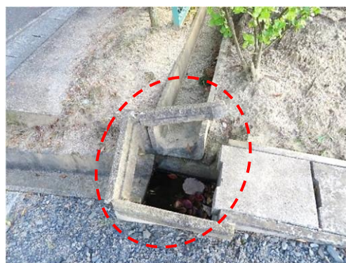
排水枡の破損
