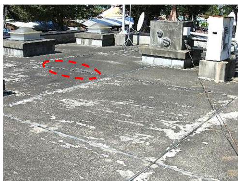
屋上防水の劣化
