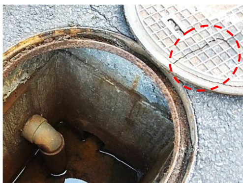
排水枡のふたの割れ
