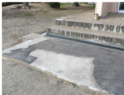
土間モルタルの剥がれによる段差
