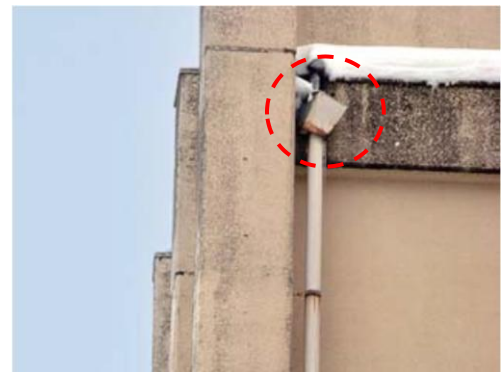
雨樋落下の危険
