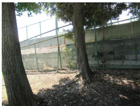
根張り障害, 隣地への越境
