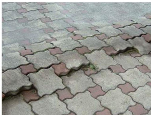
ブロック舗装の隆起
