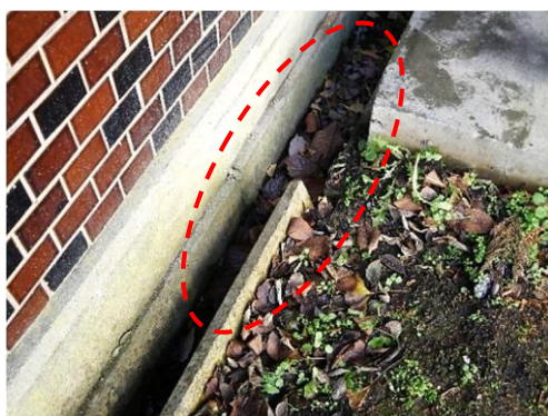
側溝の落葉による排水不良
