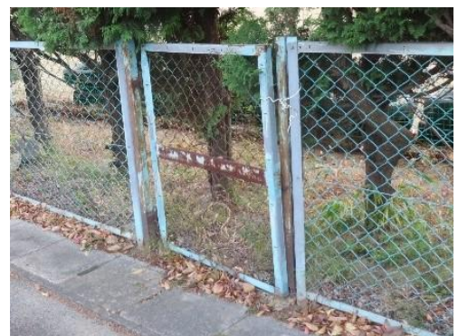
フェンスの腐食, 破損
