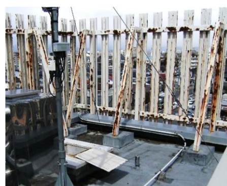
屋上フェンスの腐食（支柱の根本）
