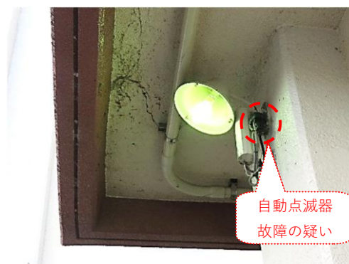
点灯異常（日中に点灯）
