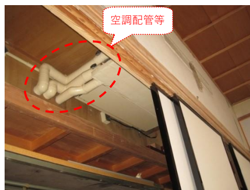
空調配管の水漏れの確認
