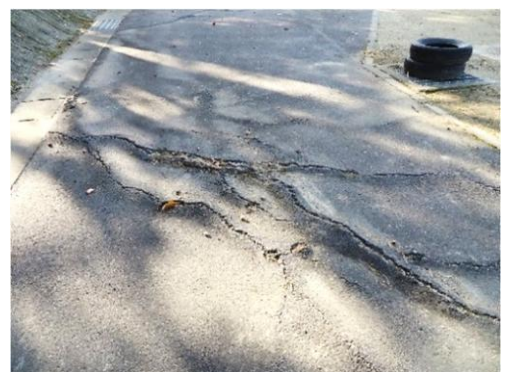
アスファルトの大きなひび割れ
