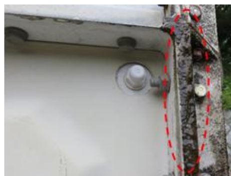
受水槽からの水漏れの疑い
