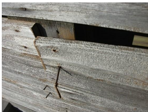
柵の破損, くぎの突出
