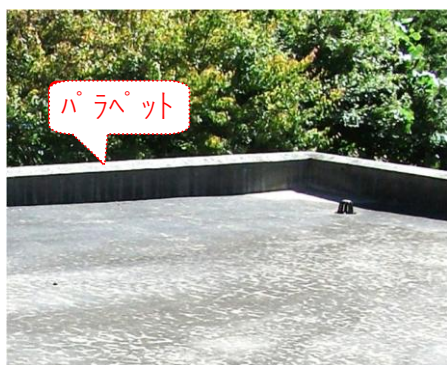
パラペットのひび割れ，浮き，破損
