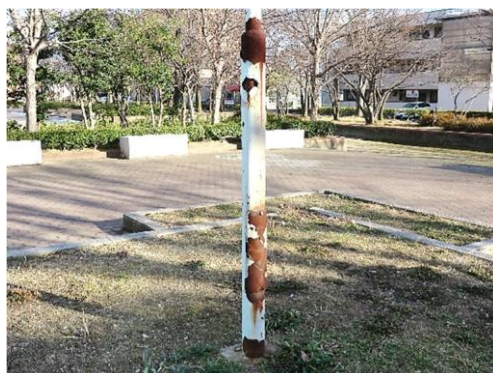
外灯や階段手摺の腐食(特に支柱の根本)
