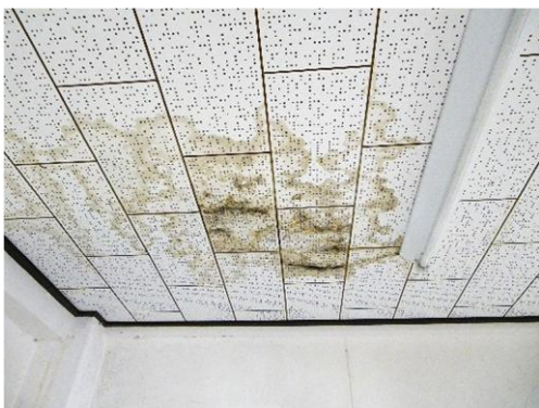
雨漏りによる天井面のシミ
