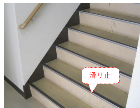
剥がれの確認
