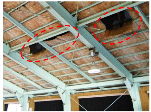
天井断熱材の剥がれ
