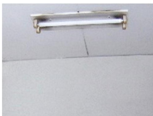
点灯不良や異音の確認
