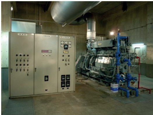
<非常用発電機>
