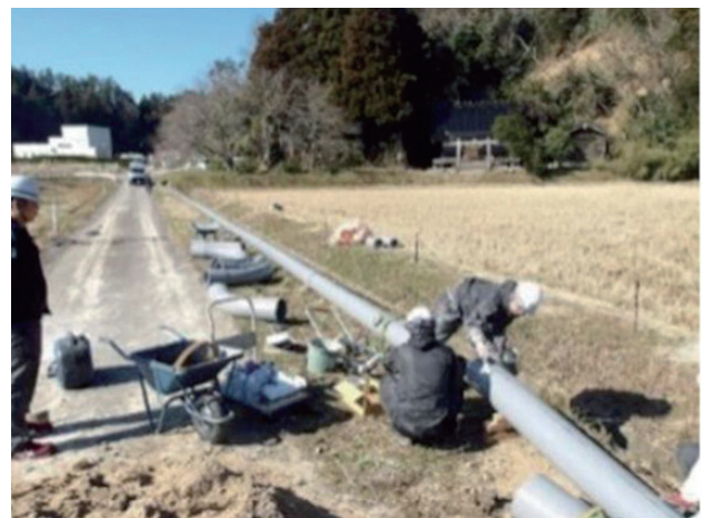
区域の下水を集約し処理場へ送る圧送管の被災
