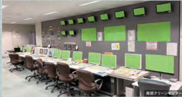
南部クリーンセンター
