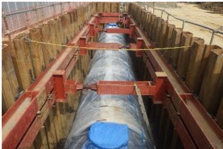
上下水道局庁舎の耐震性貯水槽（埋設型）
