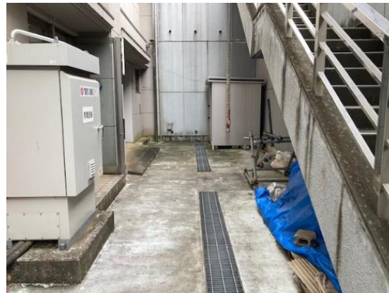
自家用発電機
