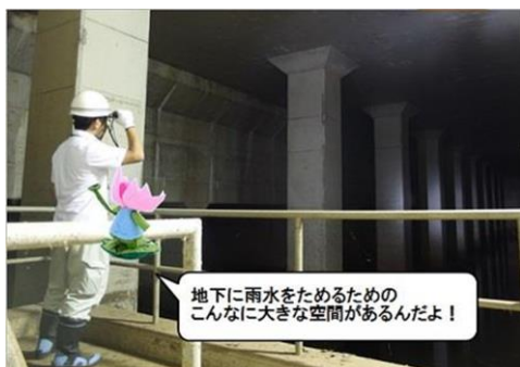
貯留施設（手賀の杜みはらしの広場）
