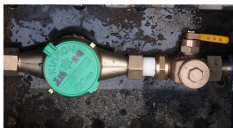
Interior de la caja del medidor
