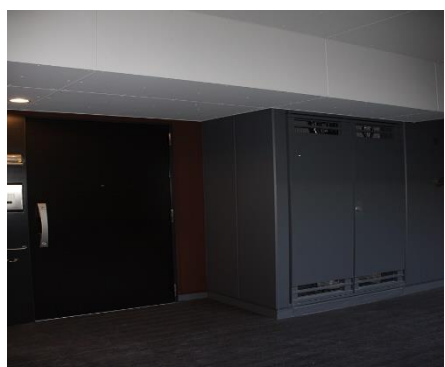
Caja de tuberías
