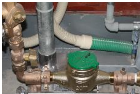
Interior de la caja de tuberías
