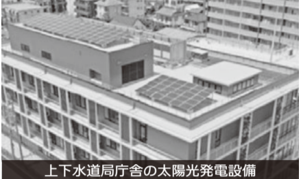
上下水道局庁舎の太陽光発電設備
