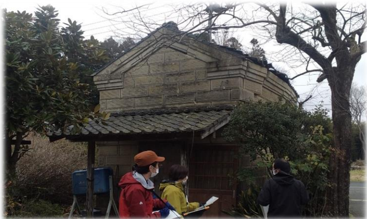
全壊判定となった非木造建物
