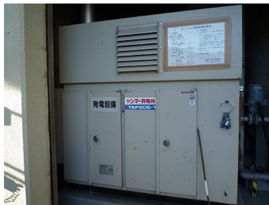
自家用発電機
