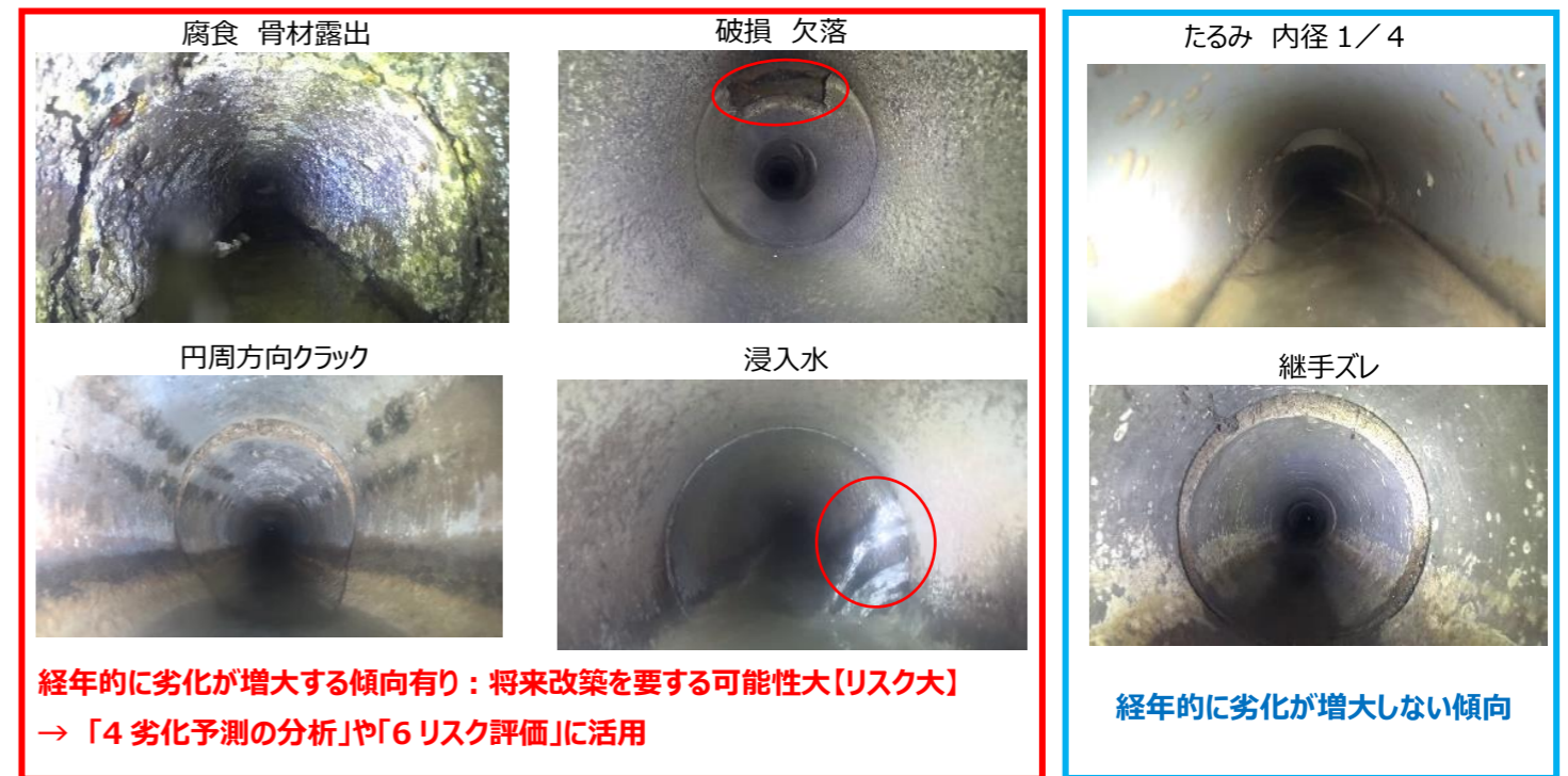
図-4 点検調査結果における下水管路の劣化状況
