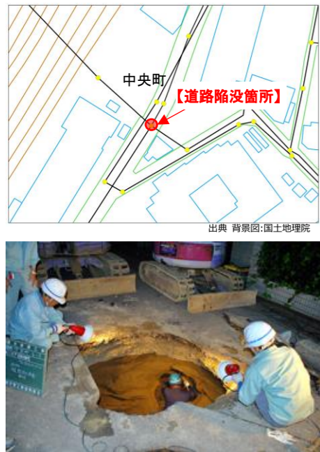
図-1 下水管路に起因した道路陥没の状況
