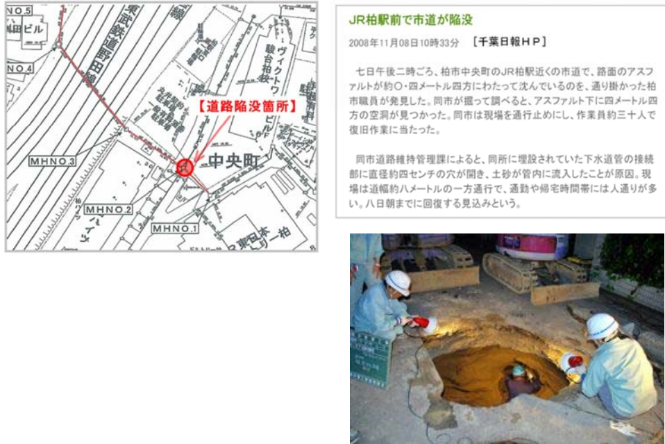
図 6-1-1 本市における道路陥没事故
