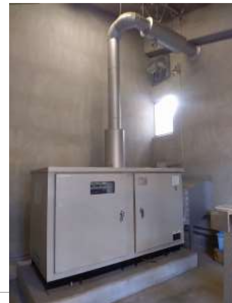
自家用発電機
