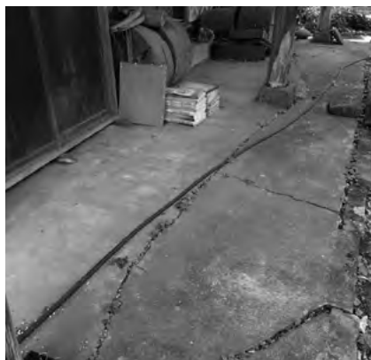
図 4-1-5 前蔵 犬走りの土間モルタルの割れ
