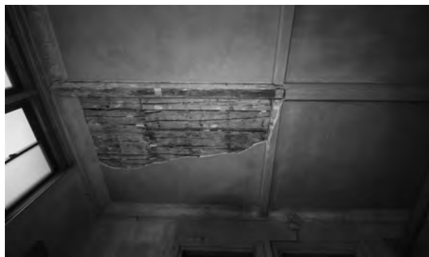
図 5-1-2 長屋門 東室天井の剥落
