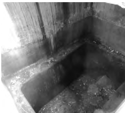
図 8-2-12 メタンガス発生装置内部
