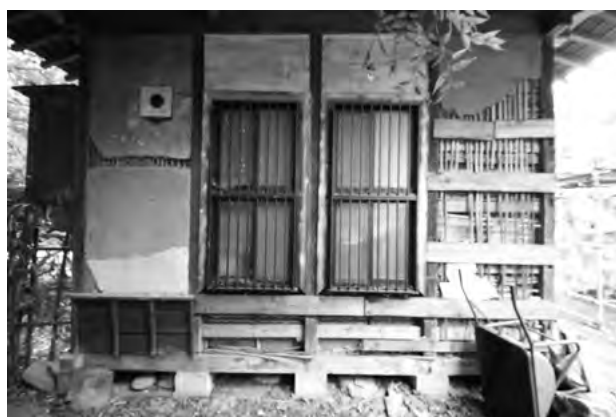
図 5-1-1 長屋門 東面外壁の崩落
