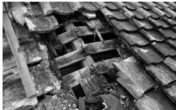
図 7-1-4 稲荷社覆屋 部分解体時に発見した下地の劣化
