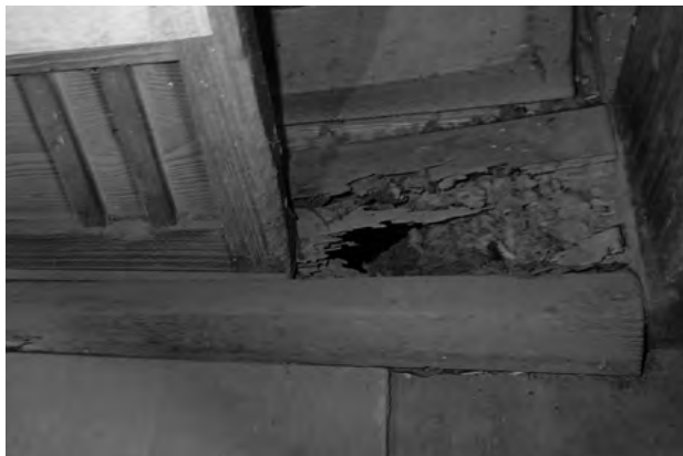
図 3-1-17 [む 13] ナンド・西縁境敷居の蟻害
