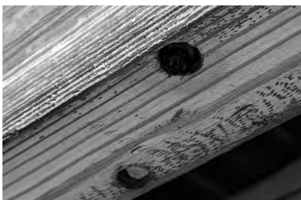
図 7-1-19 井戸屋形 正面（西面）貫のクマバチ害下面
