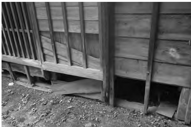
図 3-1-23 オンナベヤ北面 下見板のはずれ
