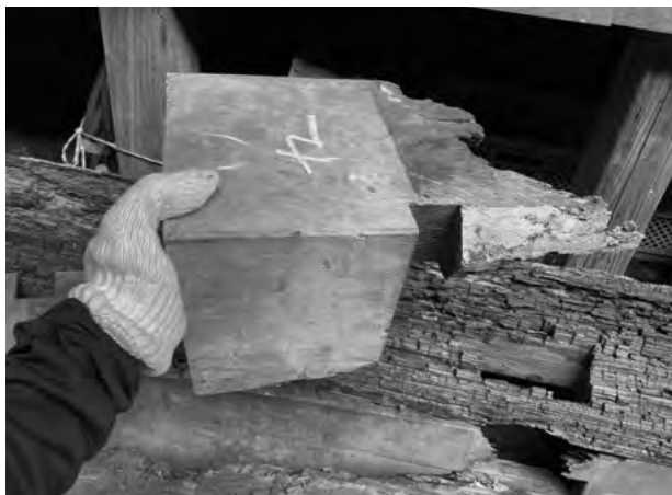
図 6-2-3 文庫蔵 木工事 修理前土台の仕口
