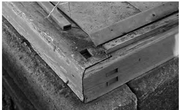
図 7-3-3 稲荷社覆屋 修理前土台
