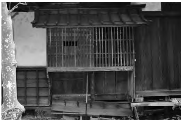
図 3-1-24 暗室南面 格子窓下下見板のはずれ
