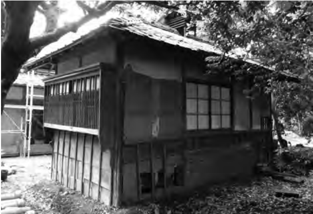
図 7-1-7 風呂場 壁の剥落
