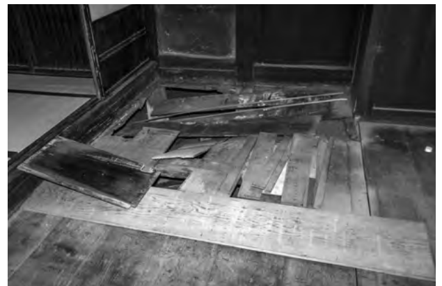
図 3-1-18 カッテ 床板崩落
