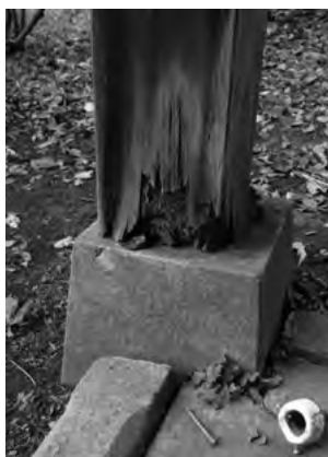
図 7-1-16 井戸屋形 北西柱脚の腐朽
