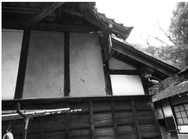
図 3-1-20 外壁漆喰の剥落
