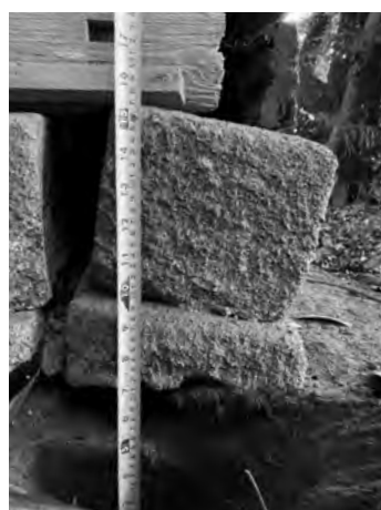
図 7-1-1 稲荷社覆屋 石積の傾き
