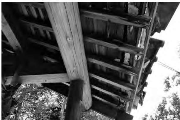
図 4-1-1 前蔵 化粧裏板と茅負の腐朽
