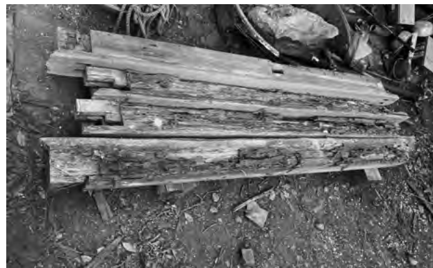
図 7-1-3 稲荷社覆屋 土台の腐朽(解体時)
