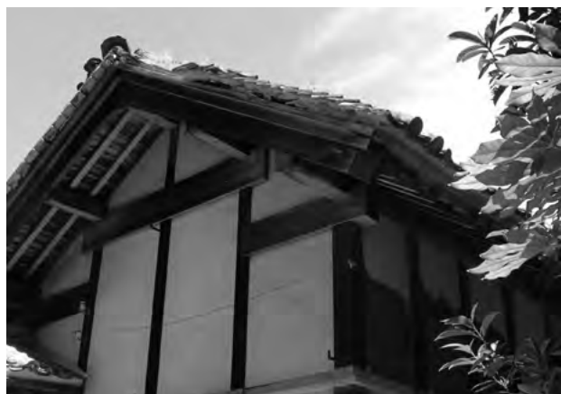
図 4-1-2 前蔵 軒瓦の落下、漆喰壁の剥落
