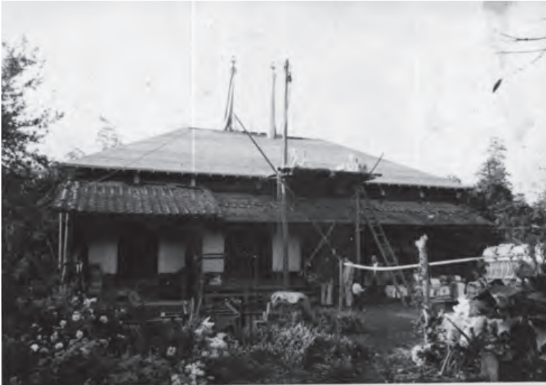
昭和 47 年（1972）の上棟式 茅葺屋根を瓦葺とするために小屋組が改造された。屋根葺替を終えた後に軒より下の工事が行われたことがわかる。画面右にこれから葺く瓦が積まれている。
