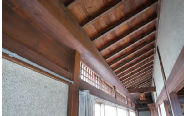
南縁 縁桁は長尺材の杉丸太。化粧軒裏、欄間には格子建具に磨りガラス。
