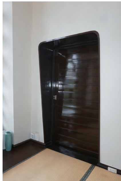
庫裡側の出入口 引き戸の建具は垂直なので、壁が傾斜しているのがわかる。
