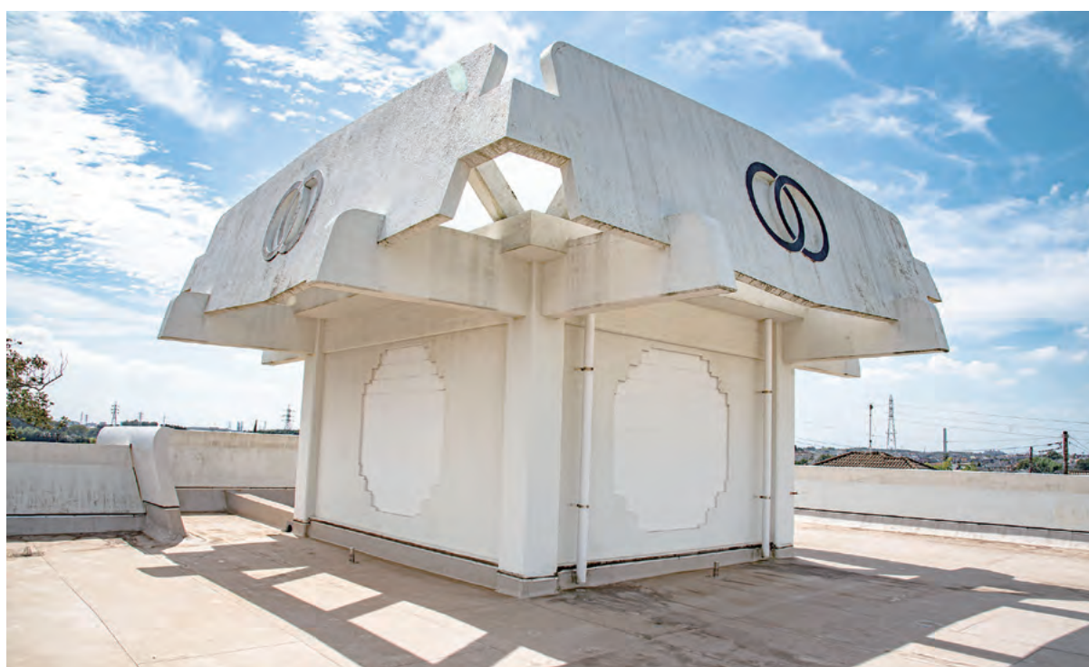
寿量院 屋上明かり取り 窓は108のガラスブロックからなるという。 現在はペンキ塗、内側からふさがれている。
