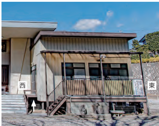
正面のベランダからも出入りできる。西面と正面に同じ間口のサッシを入れるために、西面ではベランダが前方に延長された。(↑の範囲)
