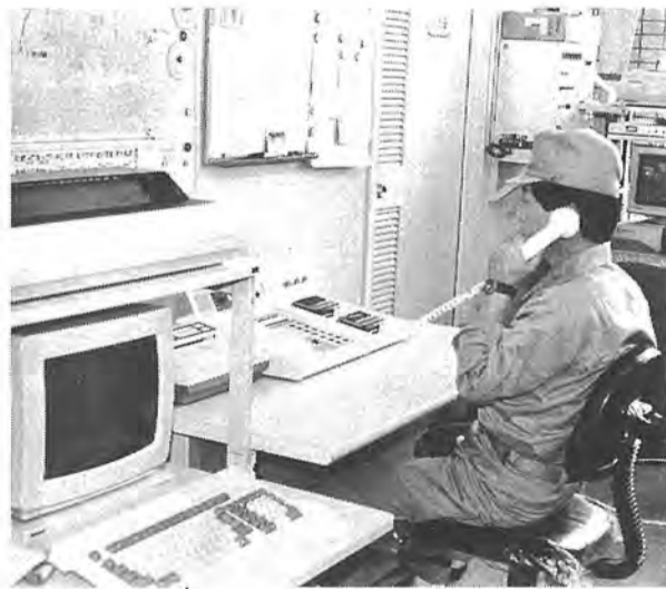
■地域防災無線システムを導入 地震などに備え、市内404カ所を無線で結んだ、地域防災無線システムが7月7日からスタート。情報の迅速な伝達・収集に威力を発揮します。
