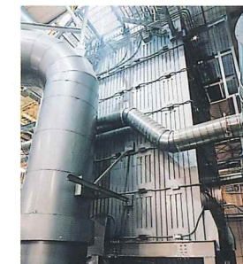
かつぜいたんきゅうちやくとう ■活性炭吸着塔 排ガス中のダイオキシンを除去します。
