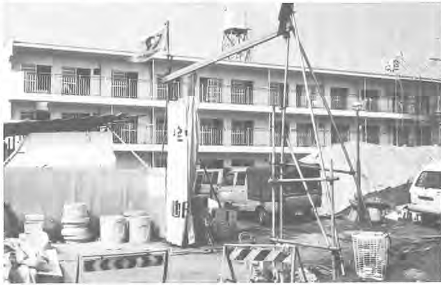
順調に工事が進められている東十余二団地市営住宅(九月十三日撮影)
