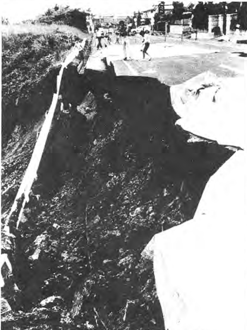
地震による道路の崩壊 (昭和53年6月 宮城県沖地震で)
