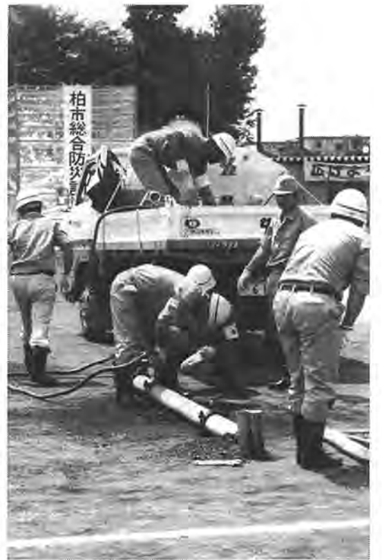
本番さながらに行われた柏市総合防災訓練。写真は水道管の復旧作業
