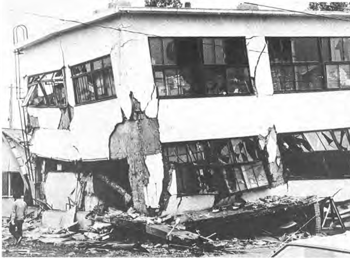
宮城県沖地震で一階が完全に破壊されたビル (写真・仙台市提供)
