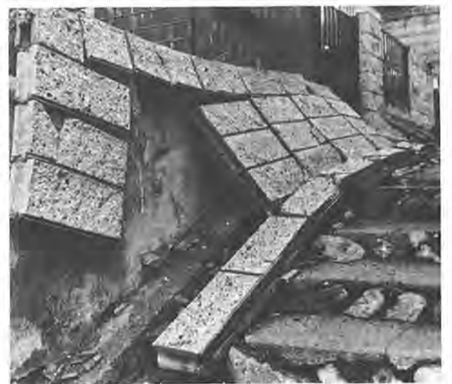
倒れたブロックべい (写真・仙台市提供)
