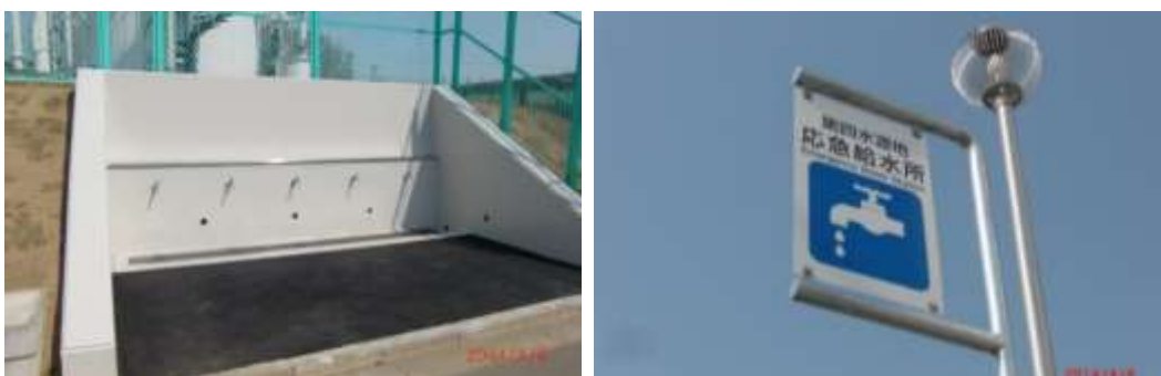
<応急給水設備>
