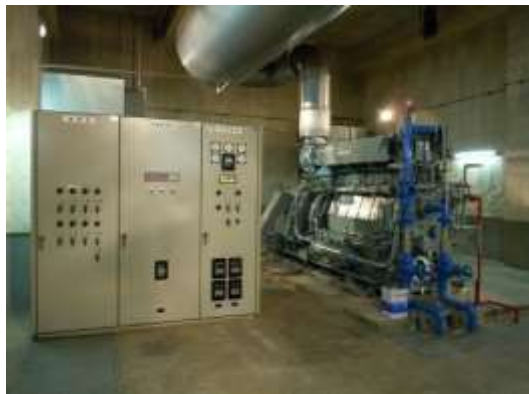
<非常用発電機>
