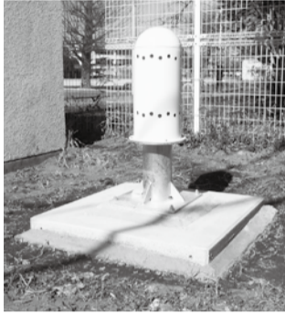
▲田中小に新設されたモニタリングポスト
