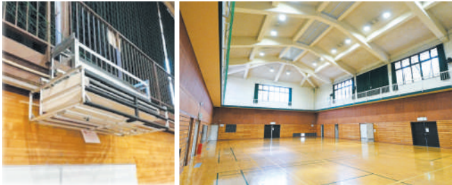
小学校に設置している 現在の近隣センター体育室 空調設備
