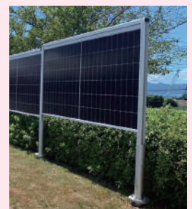
フェンス型が珍しい太陽光発電パネル
