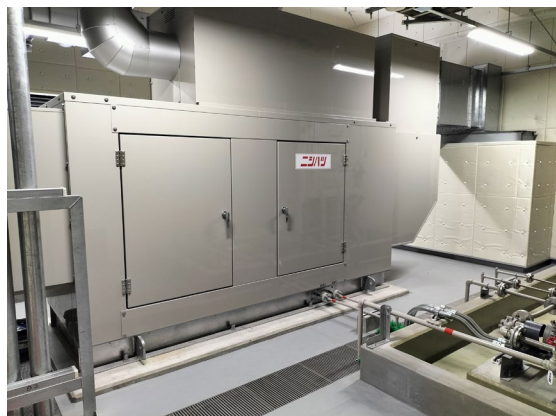
停電時に稼働する非常用発電設備
