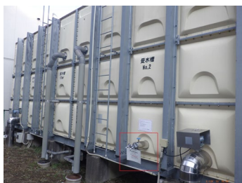
非常用給水栓
