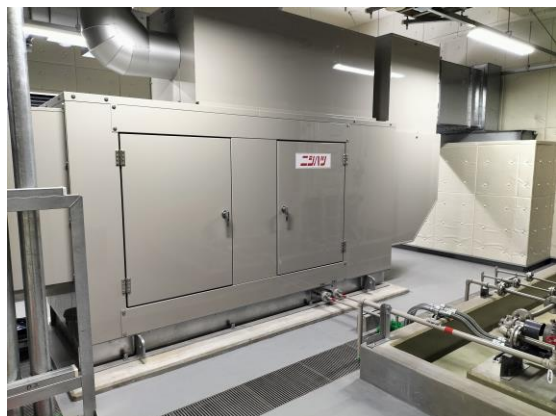
停電時に稼働する非常用発電設備
