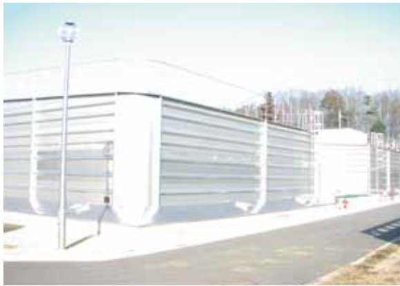
ステンレス配水池
