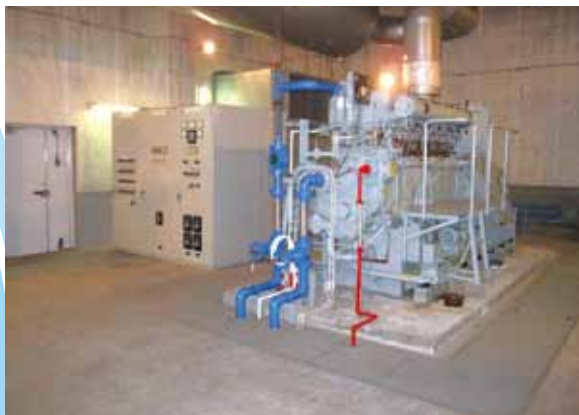
非常用発電設備
