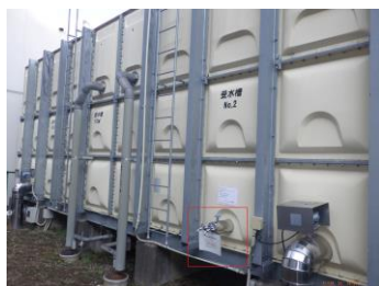
非常用給水栓
