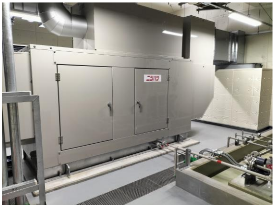
停電時に稼働する非常用発電設備
