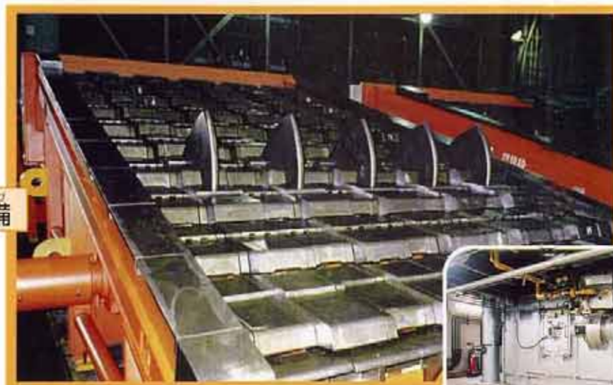
■焼却炉(内部) 投入ホッパへ運び込まれたごみを連続的に移送、攪拌し、850℃以上の高温で完全に燃焼・灰化して排出する一連の機能をもった焼却炉で、階段状の火格子と耐火レンガで構成されています。
