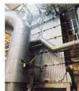
■活性炭吸着塔 排ガス中のダイオキシンを除去します。
