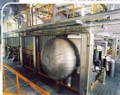
■ボイラ(外観) 焼却炉で発生する排ガスの温度を下げる的同时に、回収した熱で蒸気を発生させます。
