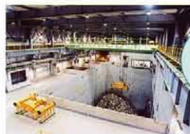
■ごみビット・ごみクレーン 運び込まれたごみは、一時ごみビットに貯留されます。ここではおおよそ1,800トン(6,000m 3 )のごみを貯留できます。
