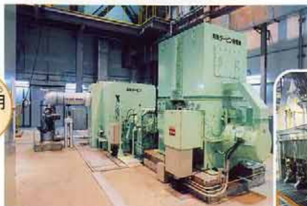
■蒸気タービン発電機 ボイラで発生した蒸気を利用してタービンを回し、最大2,500kWの発電を行います。
