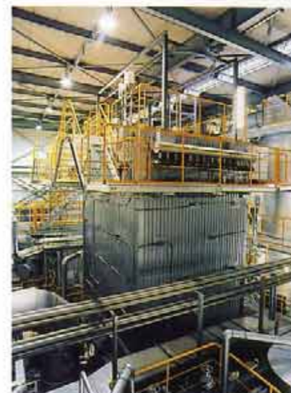
■集じん器 飛灰などのばいじんを除去します。
